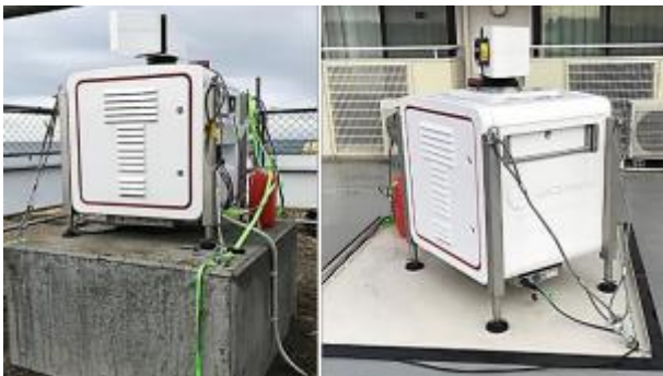
図 3.4 スキャニングライダー設置状況 34)
